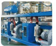
2.废料收集 2. Waste collection
